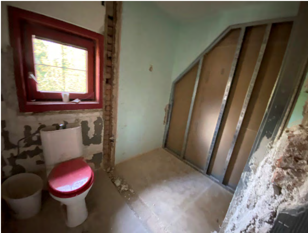
Dachgeschoss Sanitär F1
