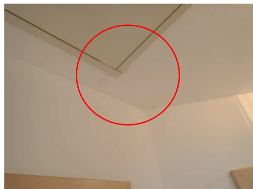
Eindringende Feuchte bei Dachbodentreppe
