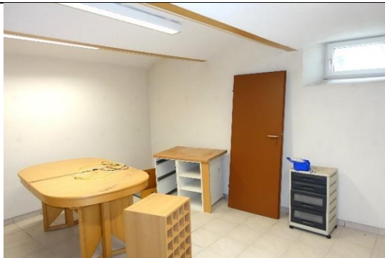
AR 2: Boden: Fliesen; Wände und Platzdecke: verputzt und gemalt; erkennbare Feuchtigkeitsschäden im Boden-Wandbereich;
