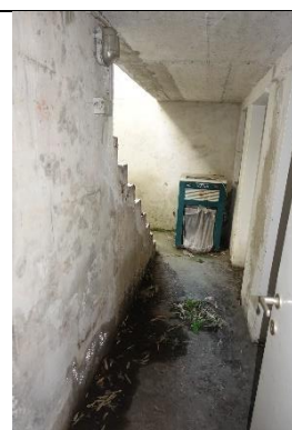
Gang: Boden: Beton; Wände: verputzt; Decke: Stahlbetondecke; erkennbare Feuchtigkeitsschäden im Boden-Wandbereich;
