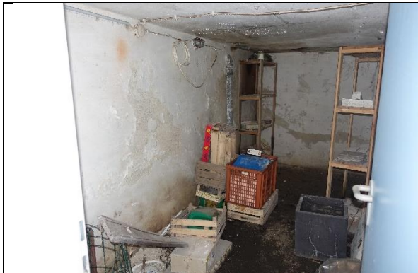
Keller 1: Boden: Beton; Wände: verputzt; Decke: Stahlbetondecke; erkennbare Feuchtigkeitsschäden an Boden und Wänden;
