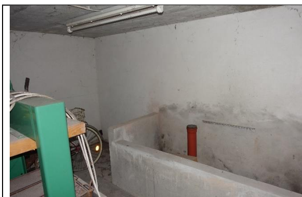
Waschküche: Boden: Beton; Wände: verputzt; Decke: Stahlbetondecke; erkennbare Feuchtigkeitsschäden an Boden und Wänden;
