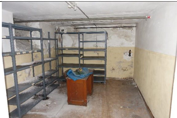
Keller 2: Boden: Beton; Wände und Decke: verputzt und gemalt; erkennbare Feuchtigkeitsschäden im Boden-Wandbereich;
