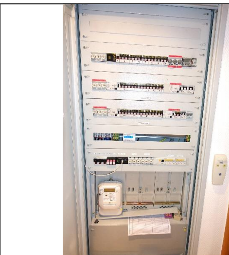
Elektroverteiler- und Zählerschrank
