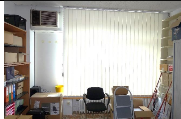
Archiv: Boden: Fliesen; Wände: Tapeten; Decke: Paneeldecke; erkennbare Feuchtigkeitsschäden an der Decke;
