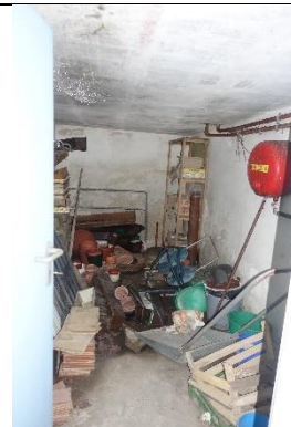
Keller 2: Boden: Beton; Wände: verputzt; Decke: Stahlbetondecke; erkennbare Feuchtigkeitsschäden an Boden und Wänden;
