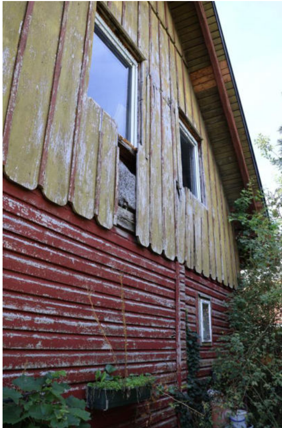
Giebelwand Nordseite mit beschädigter Holzfasadenverkleidung
