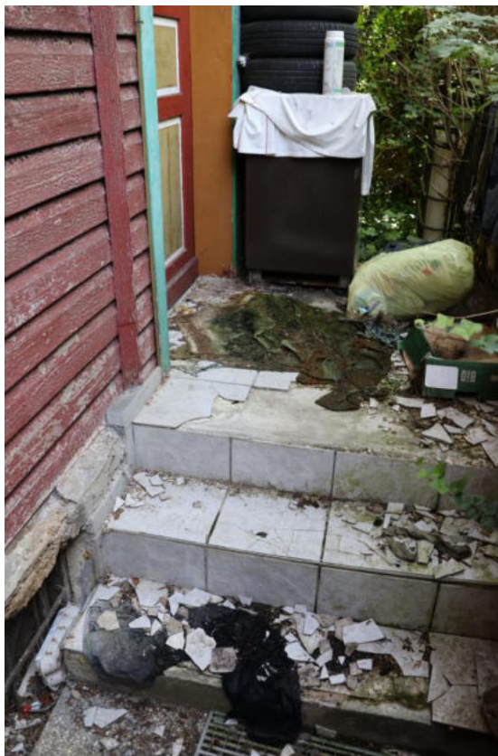
Hauszugang mit beschädigtem Fliesenbelag und stark verrecktem Podest
