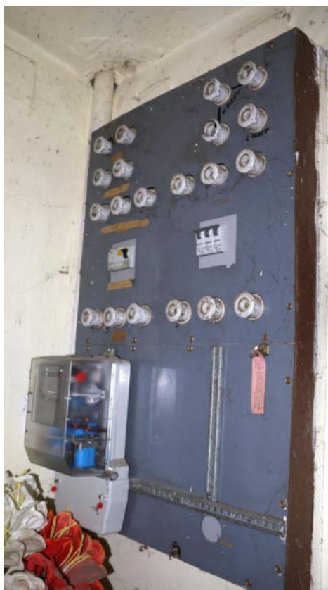
Offene E-Verteileranlage mit Schraubversicherungen im EG-Vorraum
