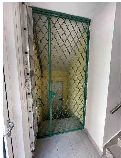
Bild 52 von 54 Blick auf den versperrten Kellerabgang im Allgmeinflur
