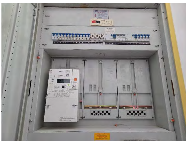
Bild 51 von 54 Blick in den Zählerkasten der Einheit (erreichbar vom Allgmeinflur)
