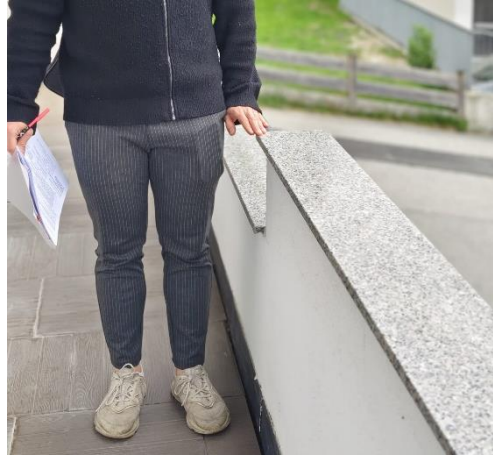
Abbildung 27: Ansicht Höhe Balkon unzureichend (6/8) 17
