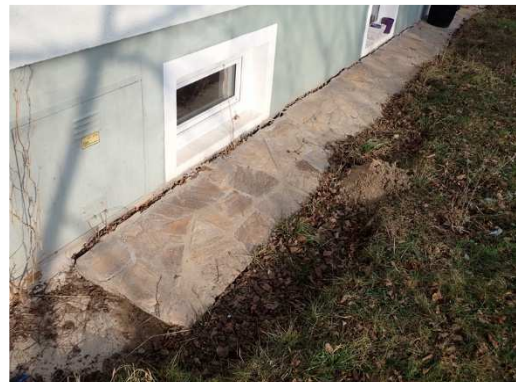
Setzungsrisse beim Traufpflaster
