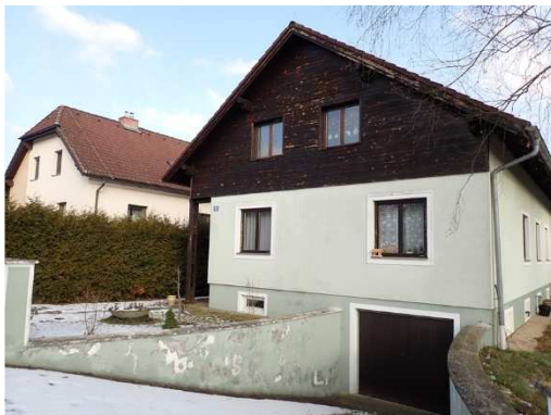
Putzschäden an Garageneinfahrt
