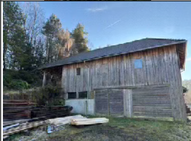
Westansicht des Wirtschafttraktes im OG Heulagerräume BJ 2006 nach Brand
