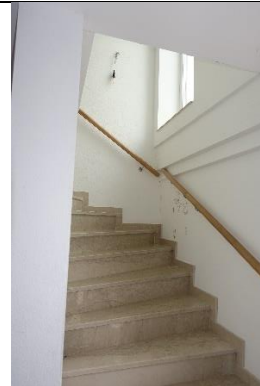
Treppe EG/OG: gefächerte Massivtreppe mit Natursteinbelag; Holzhandlauf; erkennbarer Feuchtigkeitsschaden an der Außenwand;
