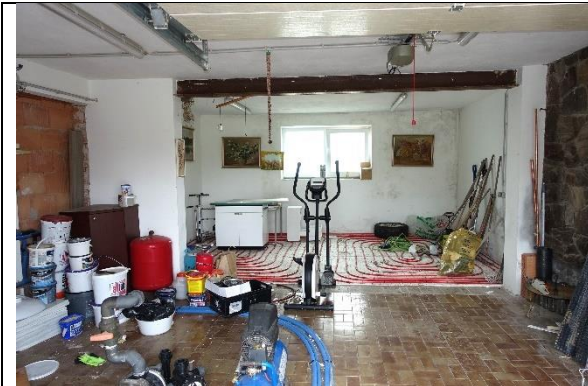
Garage 1: Boden: teilw. Fliesen, teilw. Beton mit frei liegenden Fußboden-Heizungsrohren; Wände und Decke: verputzt und gemalt; 1 Deckensektionaltor mit elektrischem Antrieb und Funkfernsteuerung;
