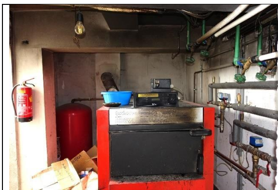
Heizraum-EG: Boden: Fliesen; Wände: verputzt und gemalt; Decke: Betonfertigteildecke geweißt; 1 Heizkessel Fabr. Strebel für Stückgut (Bj. 2001, Wärmenennleistung 60 kW)
