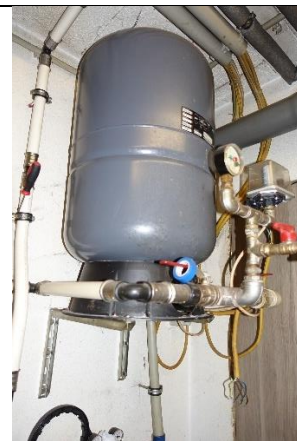
Hauswasserwerk mit Druckkessel und Filteranlage für die Wasserversorgung aus dem Hausbrunnen auf Eigengrund
