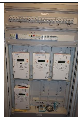
Elektrozähler- und Verteilerschrank; die Top 5 hängt zum Bewertungsstichtag am Zähler der Top 1
