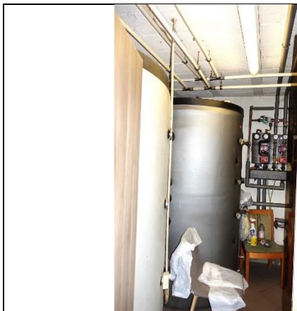
Technikraum-EG: Boden: Fliesen; Wände: verputzt und gemalt; Decke: Betonfertigteildecke geweißt; 1 Pufferspeicher (ca. 2.000 l) für die Heizung, 1 Warmwasserspeicher; die Heizung für die Top 5 hängt am Heizkreis der Top 1:
