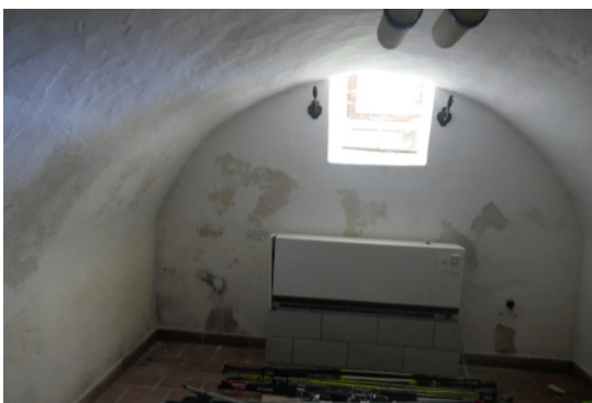
Gewölbekeller mit Feuchtigkeitsschäden
