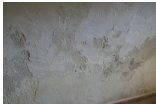
Gewölbekeller mit Feuchtigkeitsschäden
