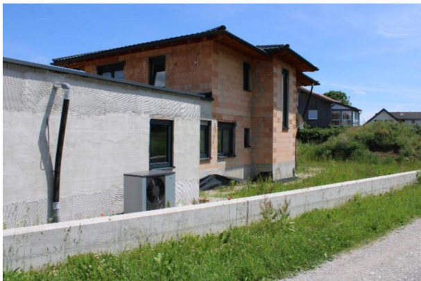
Garage mit Außenteil der Luftwärmepumpe von Westen
