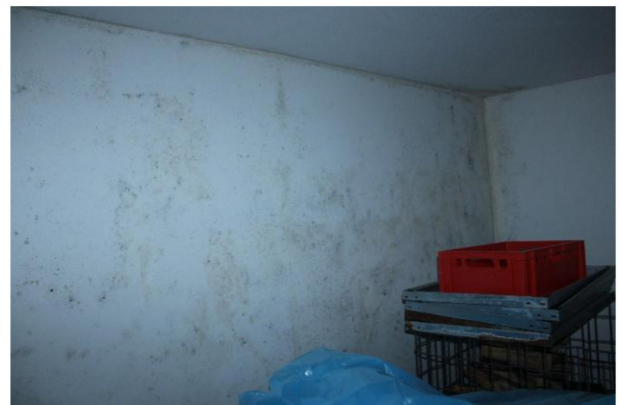
Spuren von Feuchtigkeit in der Garage
