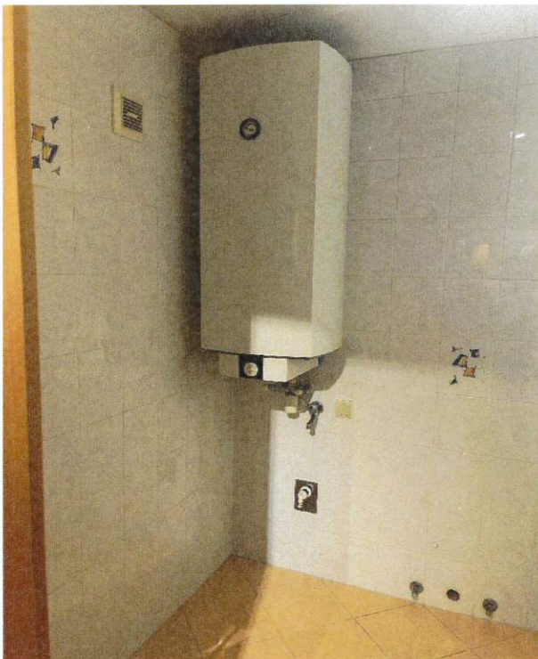
Boiler im Bad
