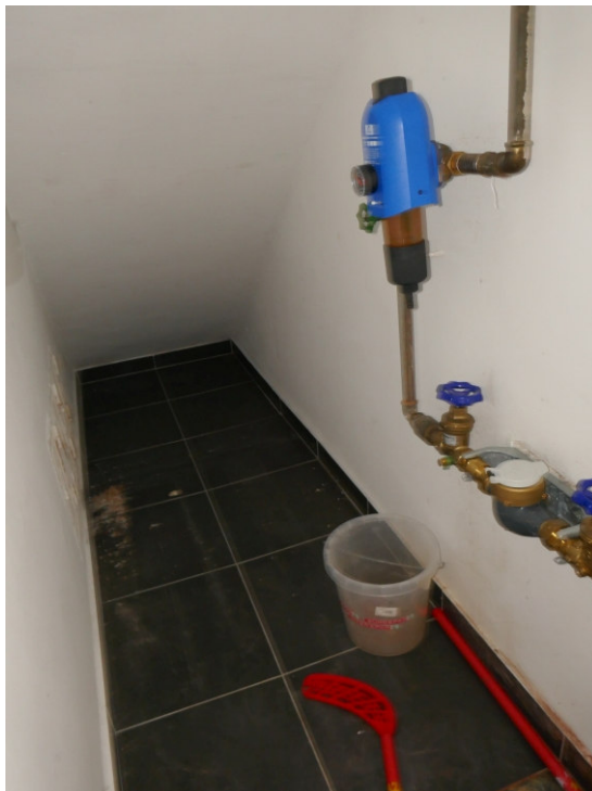
Raum unter Stiege mit Wasseranschluss
