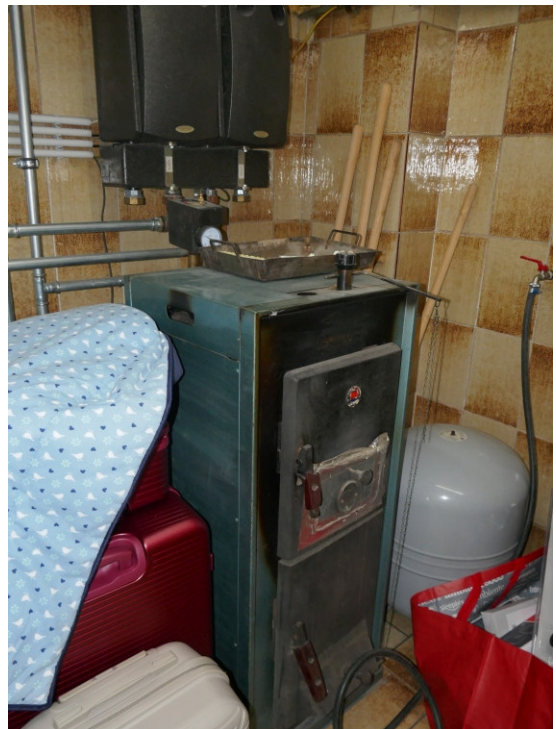
Holzofen (für Notbetrieb)
