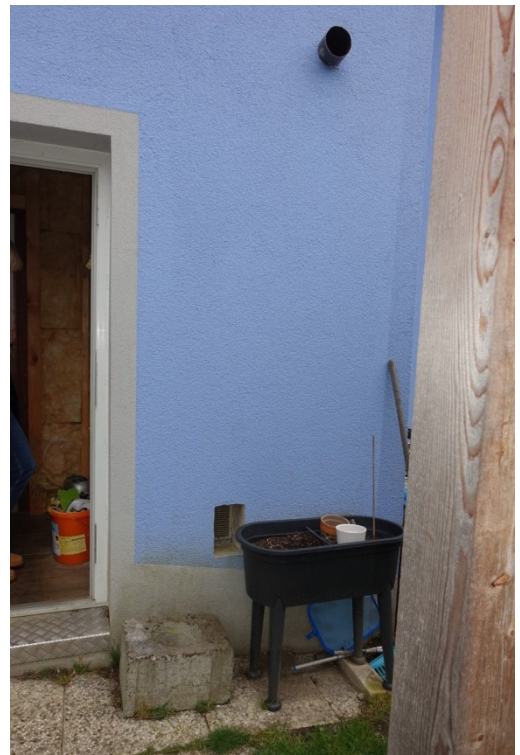
ZU- UND ABLUFT/SELCH - FOTO 27
