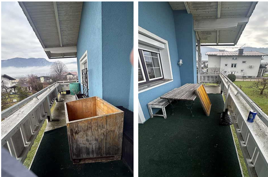
Balkon westseitig – dunkle Stellen sind Schimmelbefall
