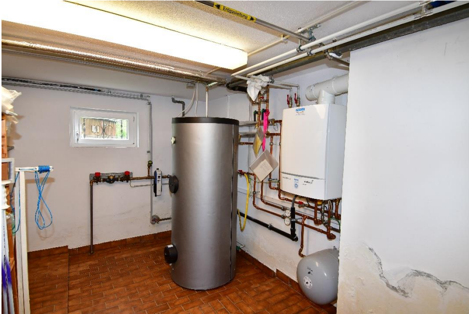
Bild 19 Kellergeschoss/ Technikraum Feuchtigkeitshochzüge
