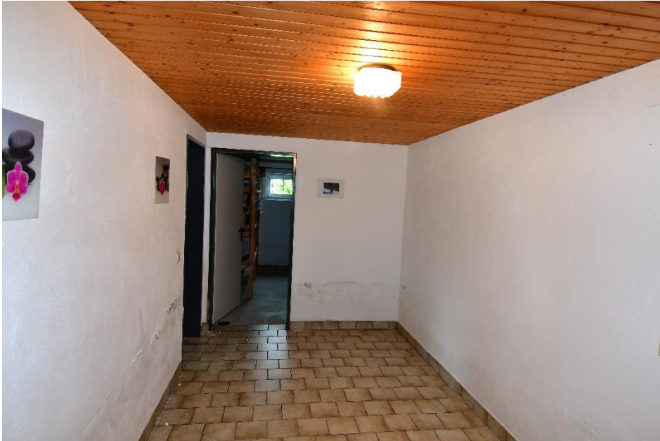
Bild 17 Kellergeschoss/ Vorkeller Feuchtigkeitshochzüge
