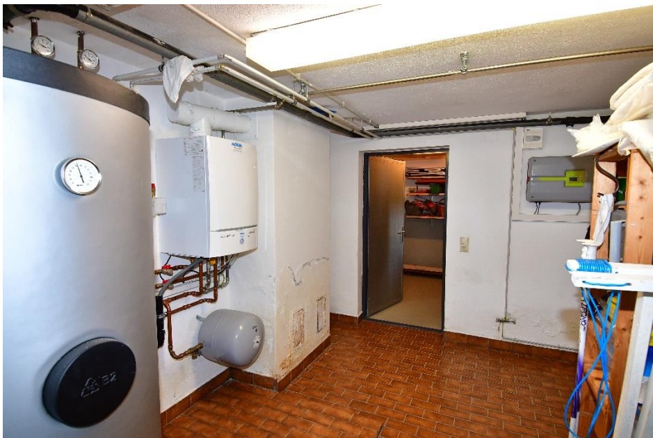
Bild 20 Kellergeschoss/ Technikraum Feuchtigkeitshochzüge
