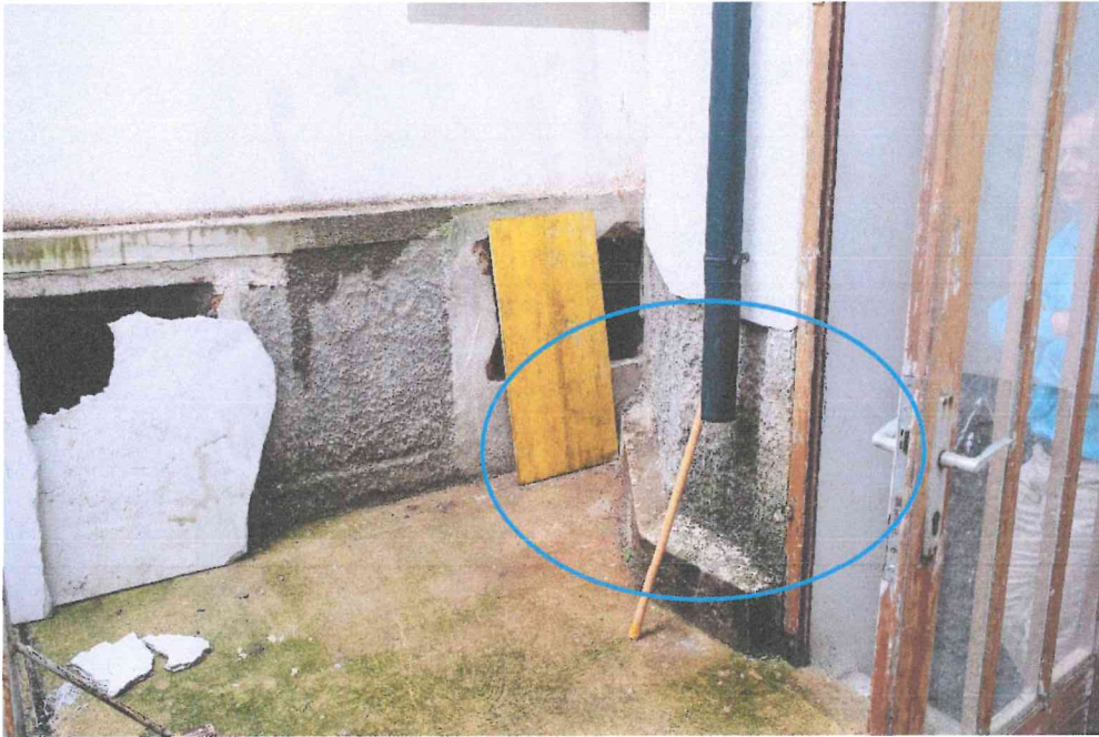
Abbildung 66: Dachentwässerung frei im Innenhof (Stiegenhaus) auslaufend
