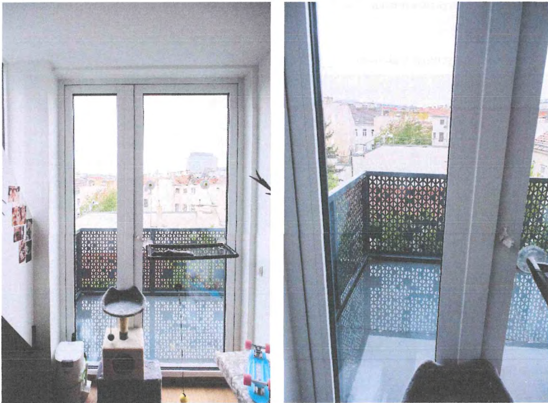
Abbildung 4: Verglaste Türen gehen nach außen auf – die Türen sind hierfür ungeeignet; TOP 36
