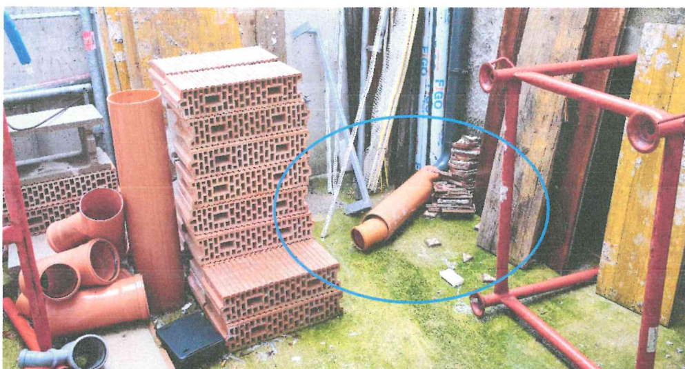
Abbildung 65: Dachentwässerung frei im Innenhof (Stiegenhaus) auslaufend
