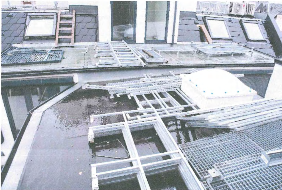
Abbildung 11: Wartungssteg unfertig, Bauteile gelagert
