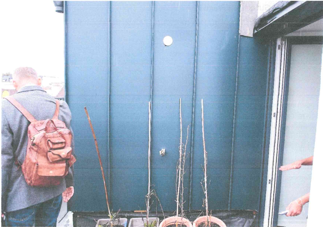
Abbildung 2: Fassade / Verblechung mangelhaft / TOP 34
