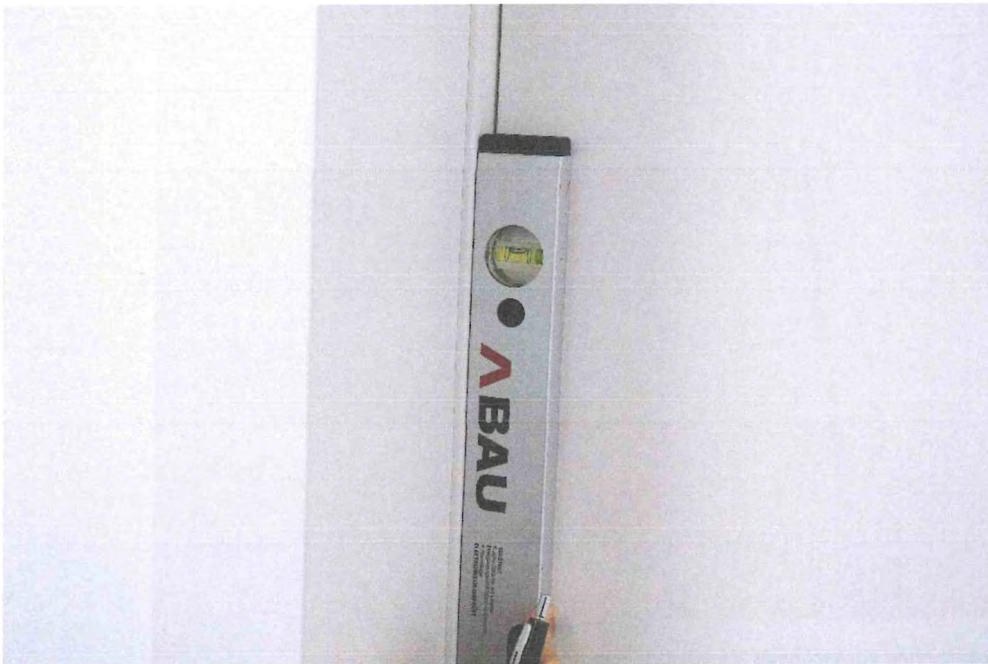
Abbildung 55: Eingangstüre TOP 20 nicht lotrecht eingebaut - dysfunktional
