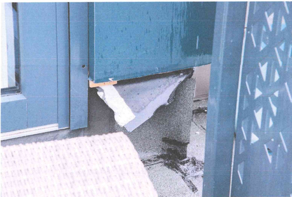
Abbildung 25: Fassadenanschluss unfertig, 2.DG, TOP 34
