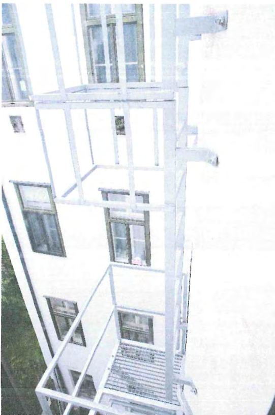
Abbildung 47: Wandbefestigung 2. Rettungsweg, Stiegenhaus
