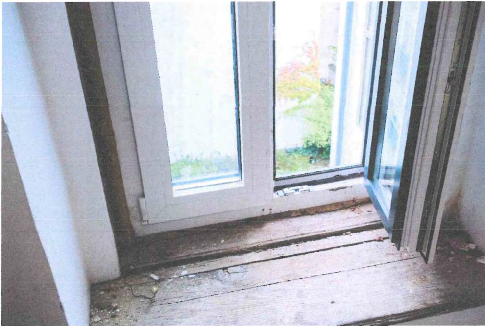
Abbildung 30: Unsachgemäßer Fenstereinbau aller "neuen" Fenster im Stiegenhaus
