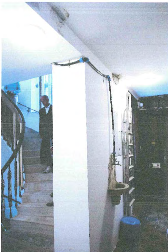
Abbildung 33; Improvisierte Wasserleitung im 3.OG
