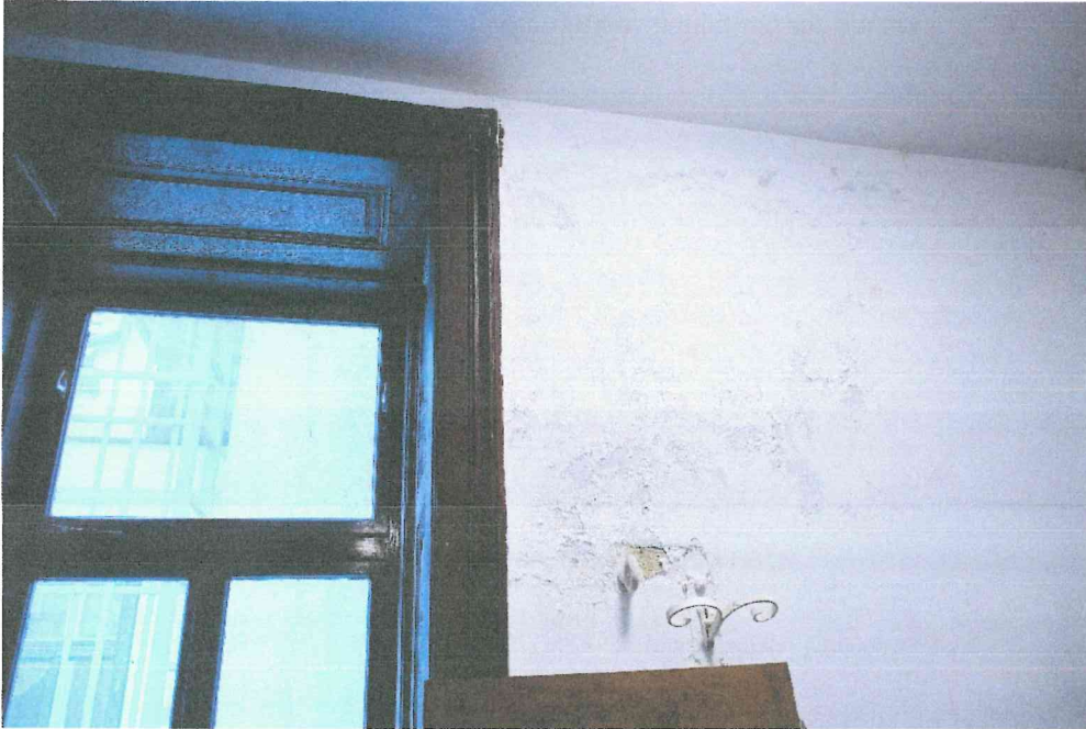
Abbildung 53: Wasserschaden im Stiegenhaus 3.OG
