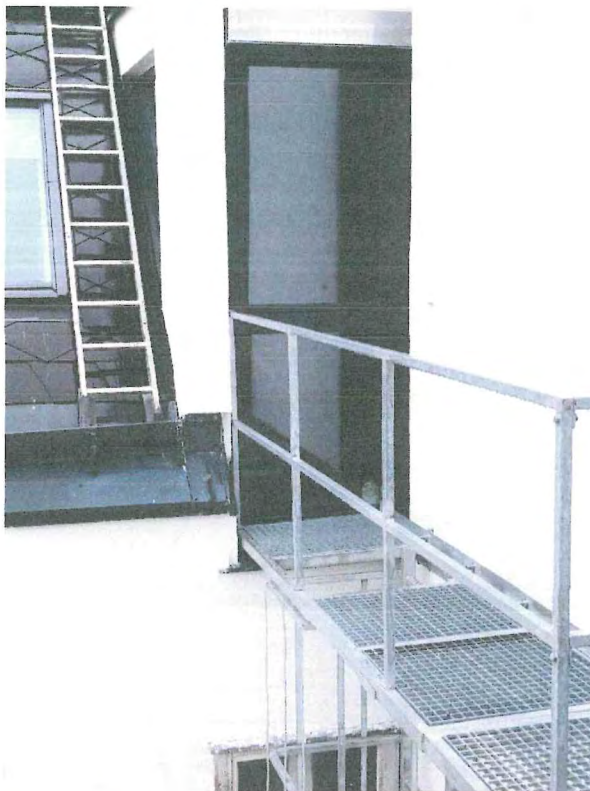
Abbildung 43: Zustieg zu 2. Rettungsweg durchs Fenster, TOP 37, Leiterüberstand fehlt
