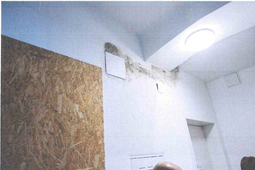
Abbildung 35: Nicht fertiggestellter Wandverputz 2.OG – links von TOP 20
