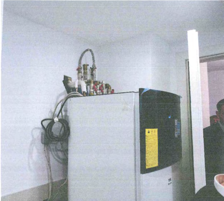
Abbildung 14: Anschluss Wärmepumpe, Badezimmer TOP 34, mangelhafte Leitungsdurchführung
