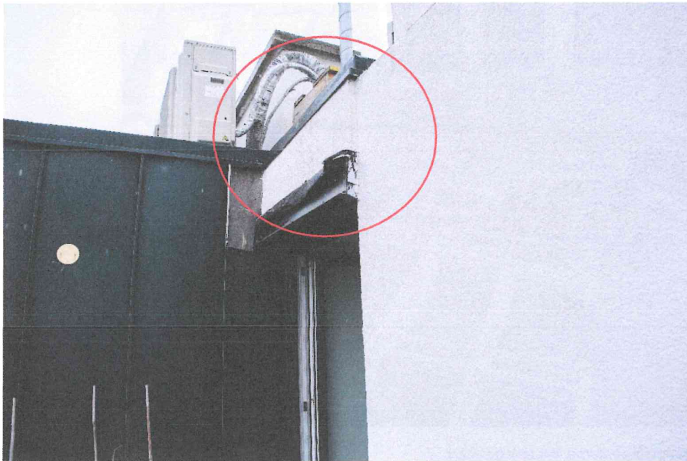
Abbildung 9: Die Leitungsführung ist unsachgemäß, Fehlstellen bei der Verblechung („weißer Bereich“ der Falzleiste) und beim Rollladenkasten (überstehende Abdichtungsfolie/-bahn)
