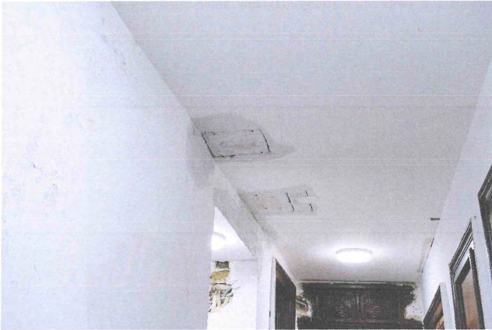
Abbildung 62: Revisionsöffnungen im Stiegenhaus - die Decke weist keine ausreichende Brandschutzqualifikation auf
