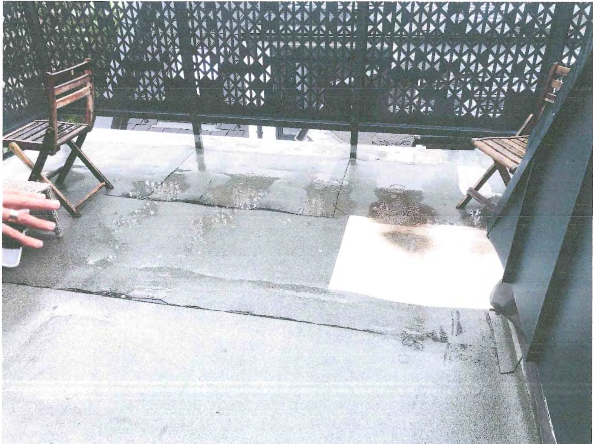
Abbildung 61: Lackenbildung in der Abdichtung
