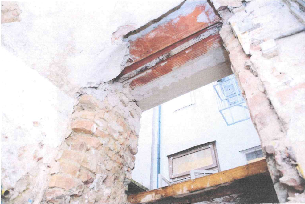
Abbildung 79: fehlendes Kellerfenster zum Innenhof Stiegenhaus
