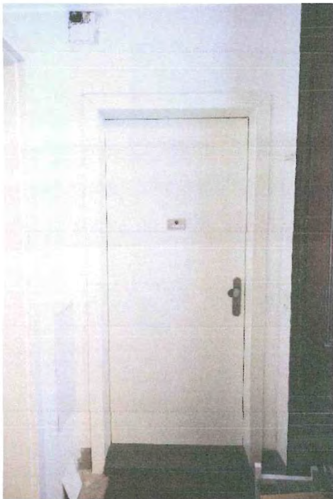
Abbildung 71: Wohnungseingangstüre - ungleiches Spaltmaß weist auf einen unregelmäßigen Einbau hin
