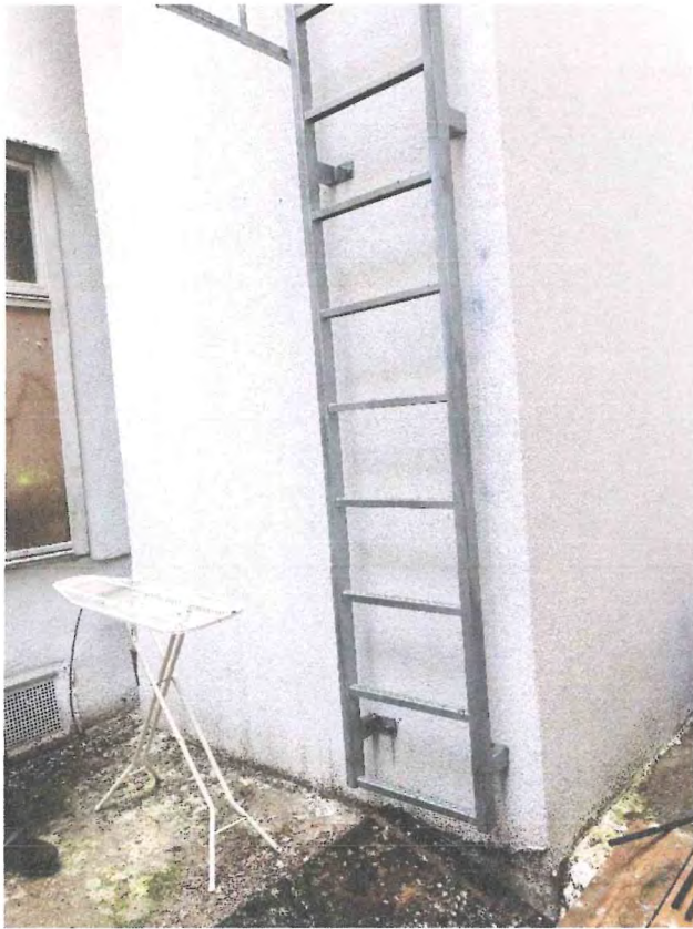
Abbildung 44: Fußpunkt 2. Rettungsweg keine Aufstiegssicherung, Innenhof Zugang
