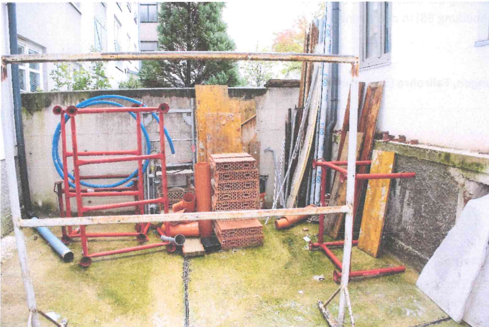
Abbildung 67: Dachentwässerung frei im Innenhof (Stiegenhaus) auslaufend
