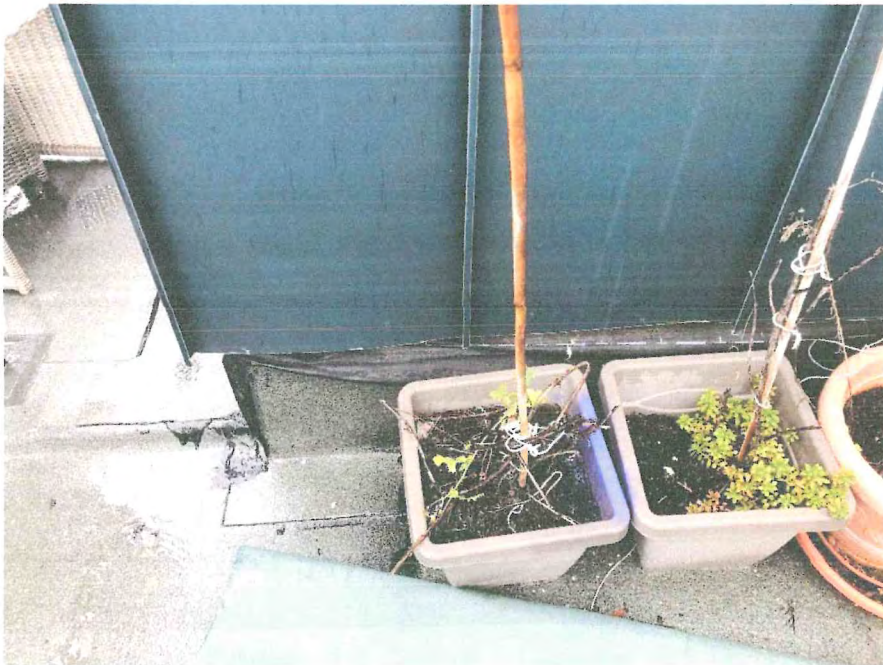
Abbildung 27: Fassade 2.DG, Top 34 unfertig, siehe auch 4.1
