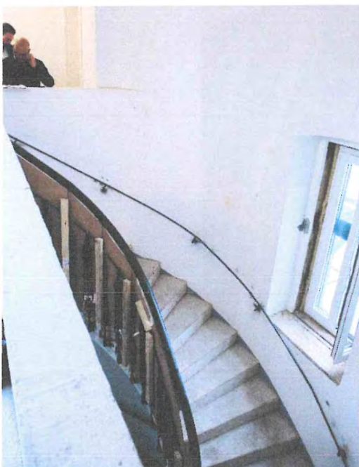
Abbildung 17: Improvisierter Handlauf / Geländer zwischen 3.OG und 1. DG
