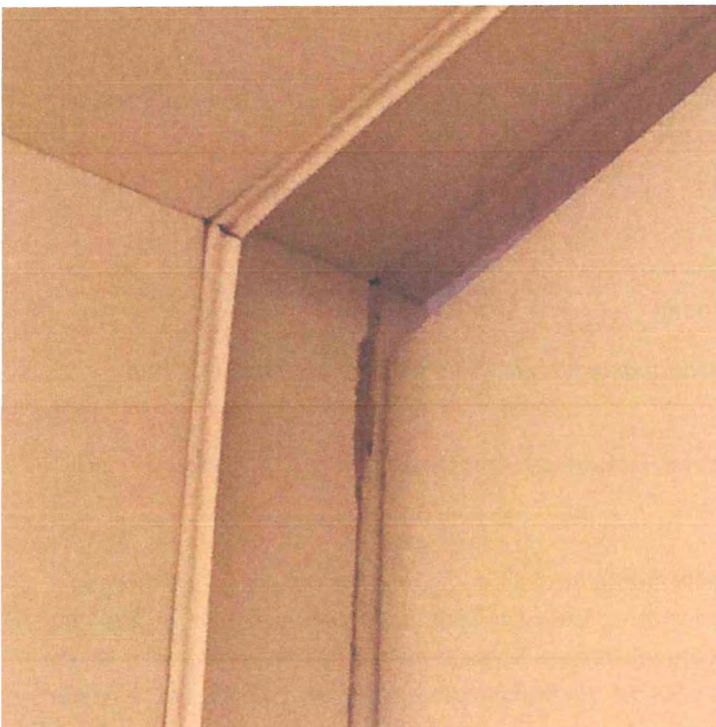
Abbildung 56: Innentüre ohne ausreichende "Einbauluft" montiert (Spaltmaß)
