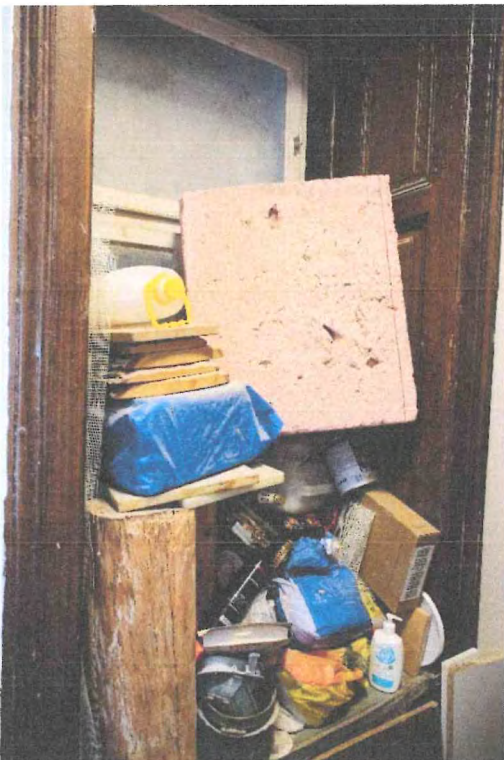
Abbildung 31: Durch Liftschacht unbrauchbares Fenster – 2. OG
