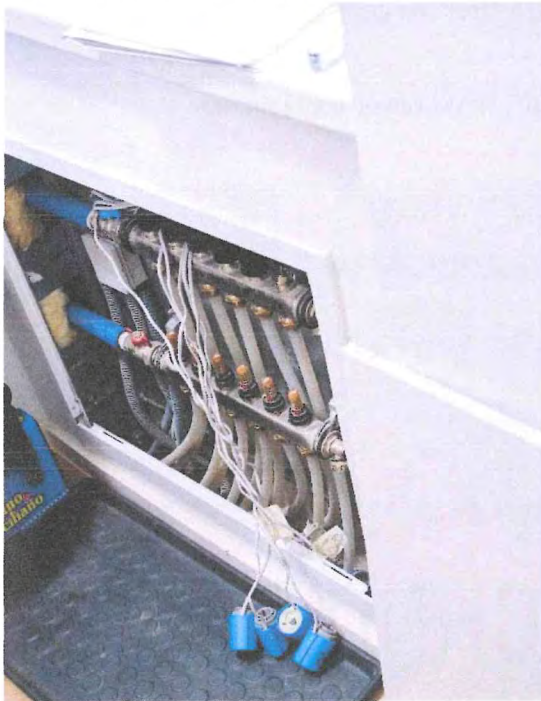
Abbildung 75: Heizungsverteiler - Fußbodenheizung TOP 22
