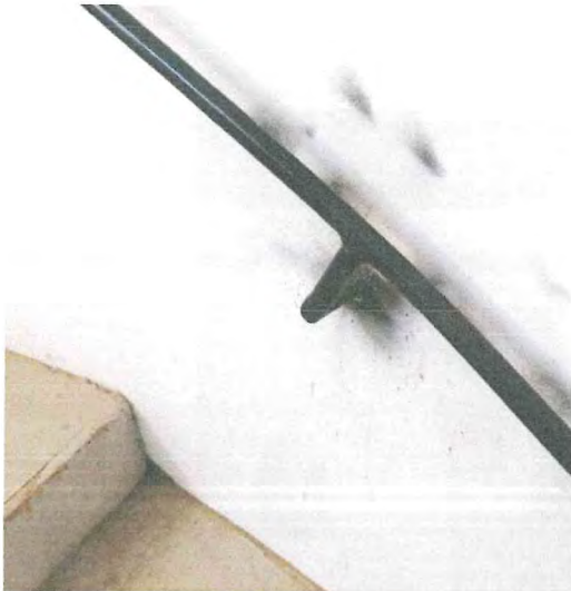
Abbildung 18: Beim Anstrich des Handlaufes wurde die Wand verunreinigt
