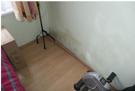
Wasserschaden Schlafzimmer EG
