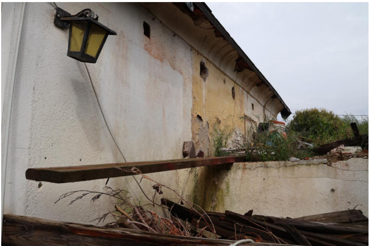
Bild 10 Offene Fassadenlöcher entlang der Ostseite beim Zubaustrakt
