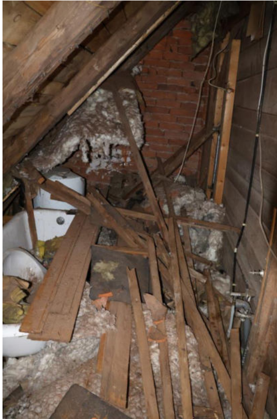
Bild 35 Dachboden mit Ablagerungen hinter der Holz-Drempelwand
