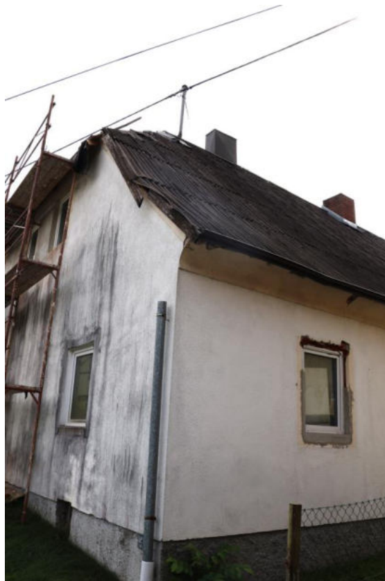
Bild 42 Nordwestliches Gebäudeeck mit abgebrochener Dachrinne und offenem Ortgang
