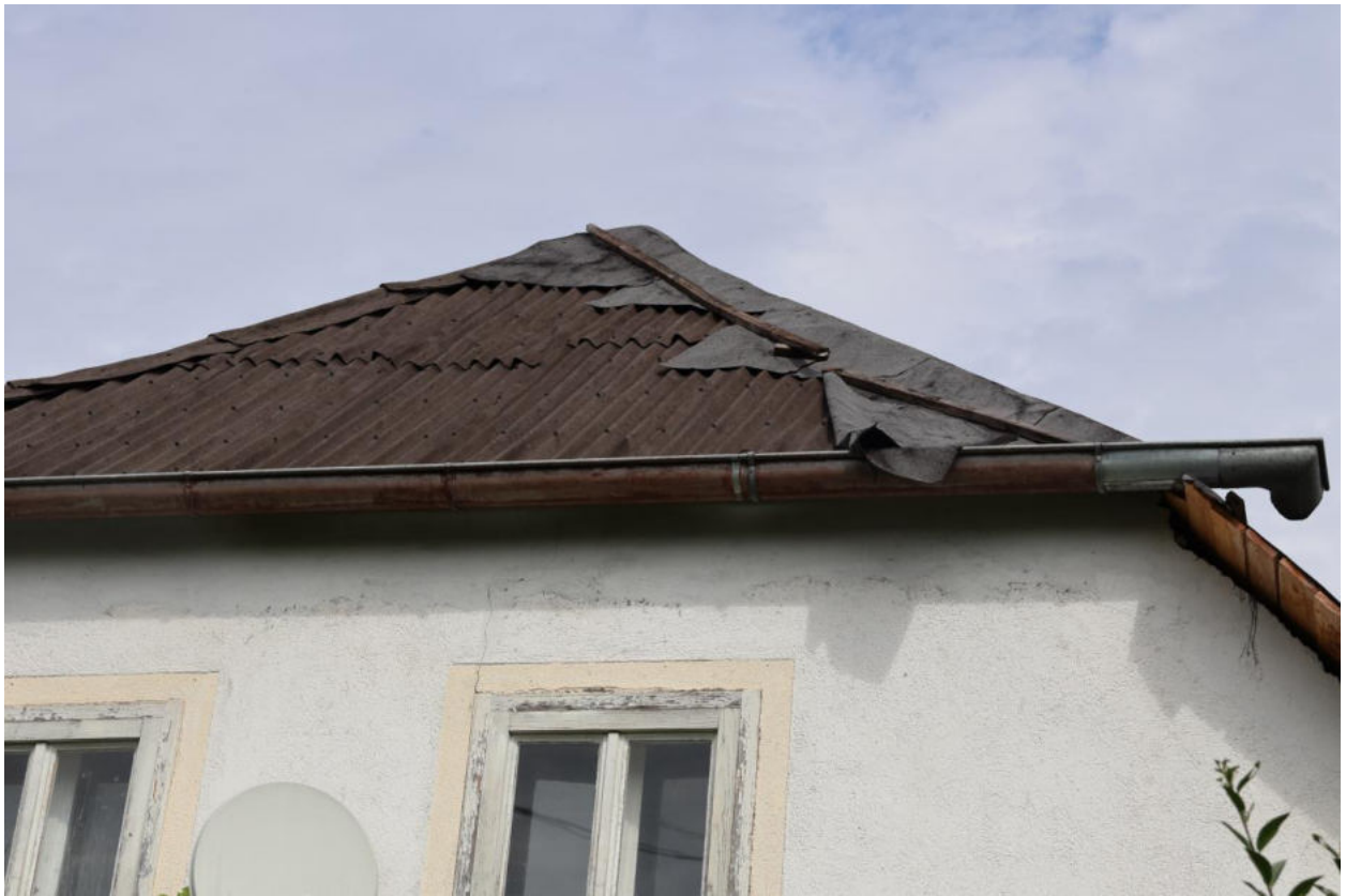
Bild 13 Krüppelwalm Südseite mit provisorischer Bitumenbahnabdeckung
