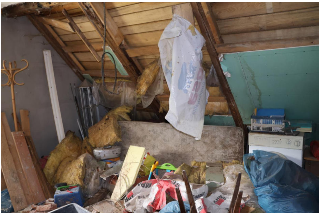
Bild 32 Dachflächenuntersicht mit Nässeflecken
