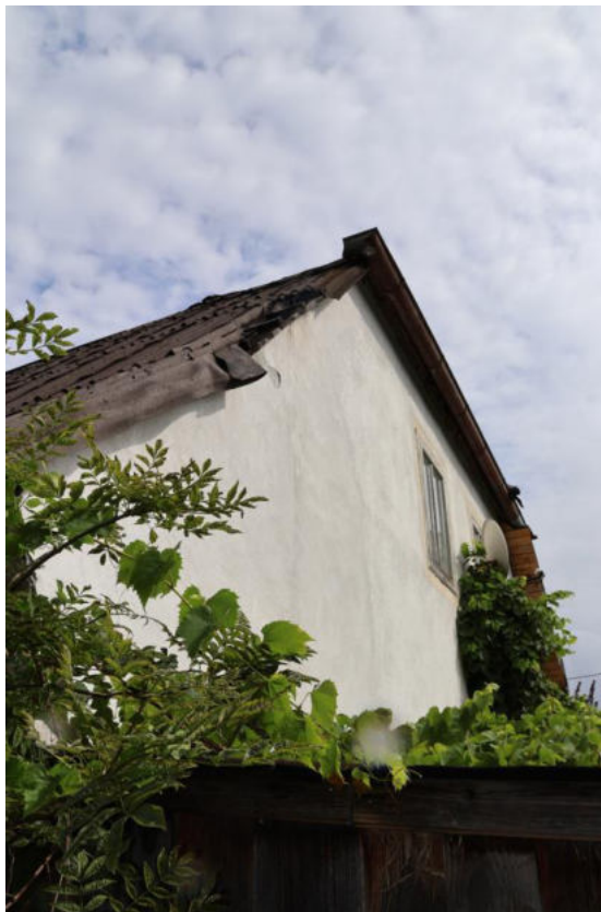
Bild 12 Giebelwand Südseite mit aufgerissener bzw. offener Dachfläche
