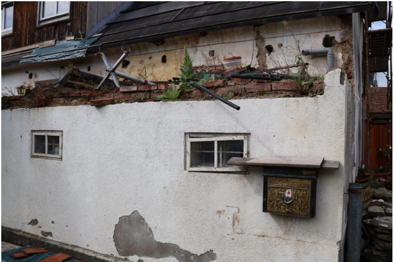
Bild 9 Dachabbruch vom EG-Zubaustrakt an der Ostseite
