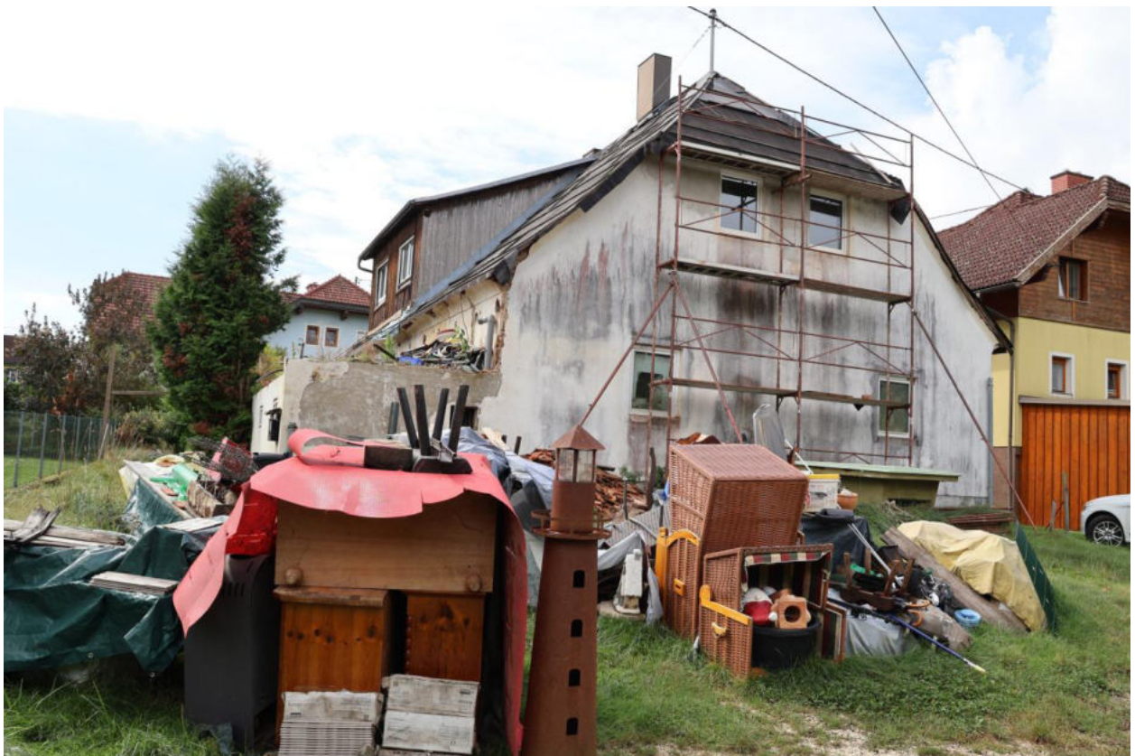
Bild 2 Gebäudeansicht Nordseite mit Bauschutt und Sperrmüllablagerung
