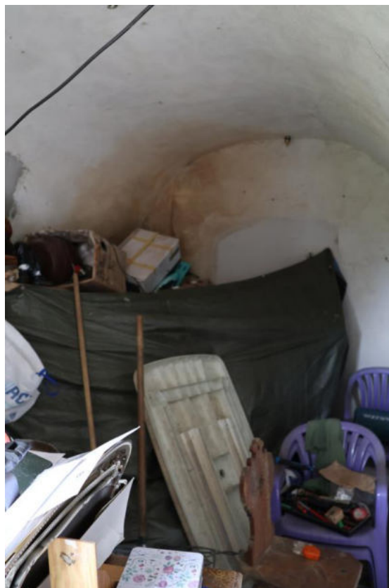
Bild 22 EG mit Wanddurchfeuchtungen im Deckenbereich
