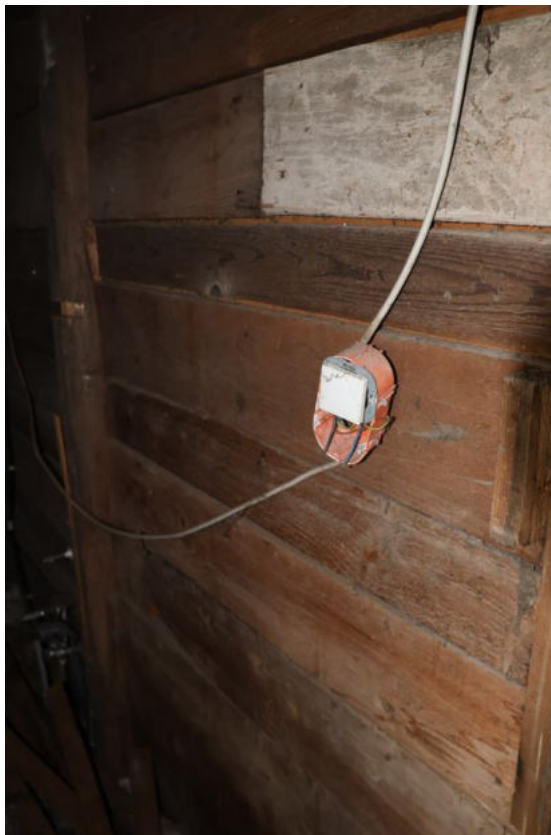
Bild 36 E-Kabel mit offenem Lichtschalter!
