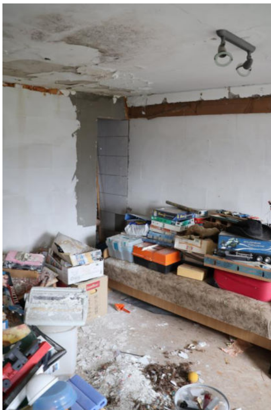
Bild 38 Feuchteintritt an der Dachbodendecke
