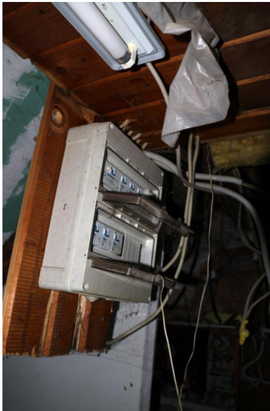
Bild 37 Überbrückter E-Subverteilerkasten im Dachboden
