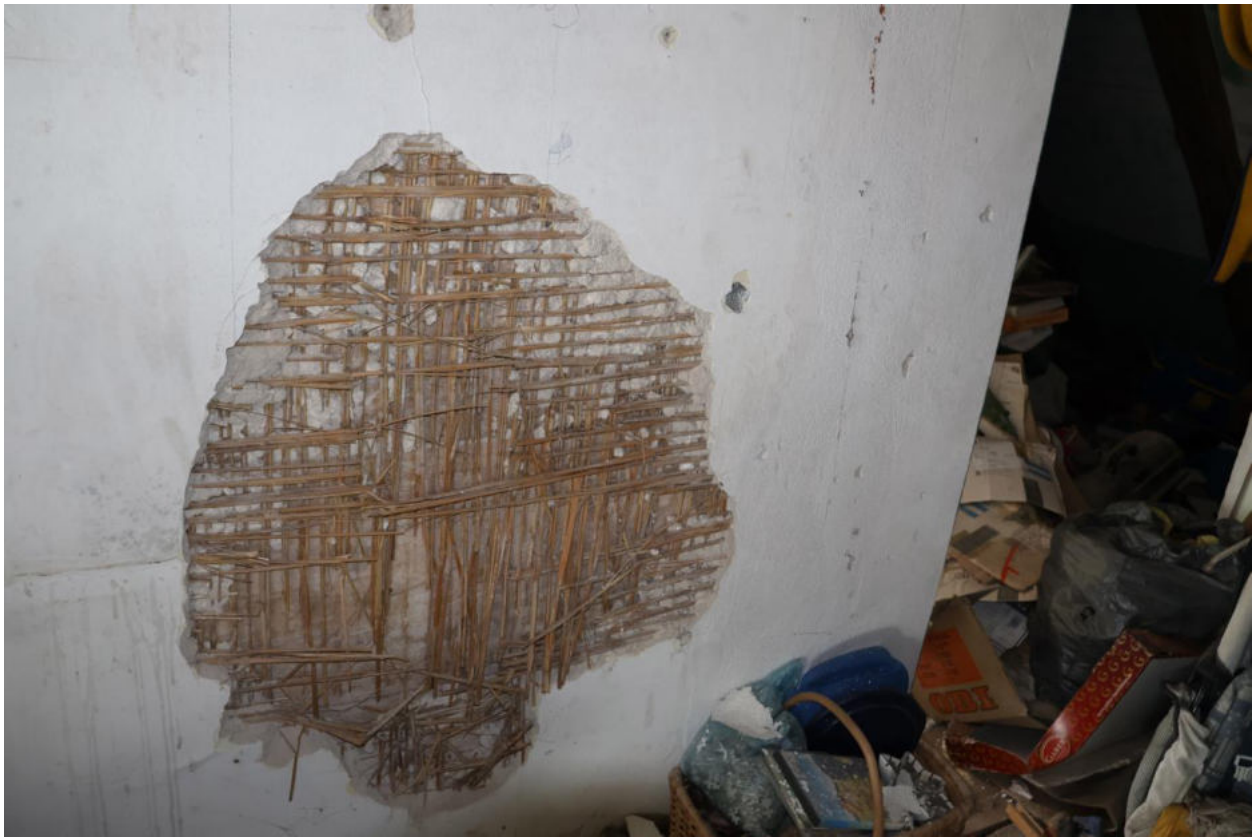
Bild 39 Putzschäden bei der Drepelwand im Dachboden
