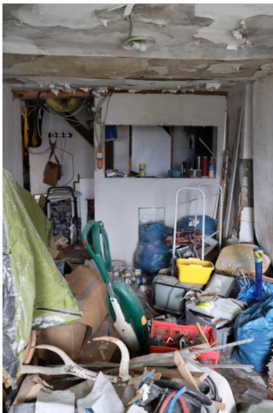
Bild 34 Dachboden mit Feuchteschäden und Sperrmüllablagerungen
