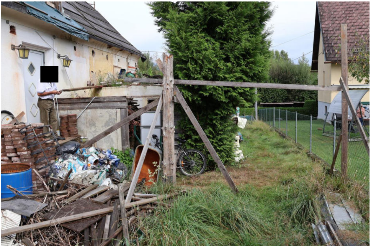
Bild 8 Sperrmüll und Bauschuttalagerungen beim östlichen Hauszugang
