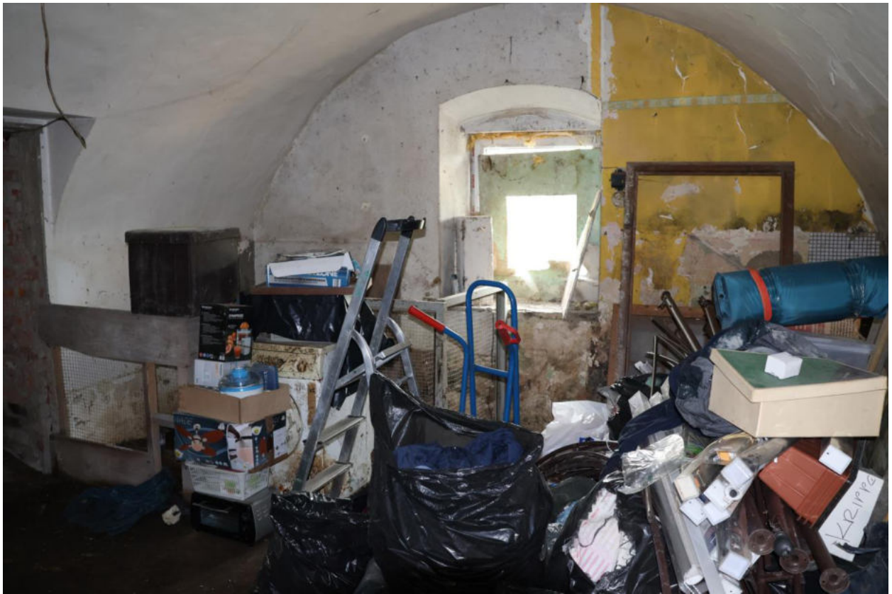
Bild 21 EG Abstellraum mit diversen Sperrmüll-Ablagerungen
