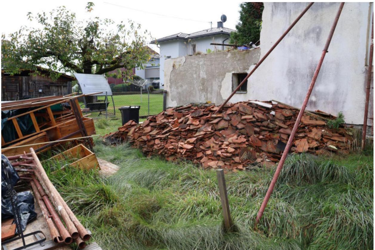
Bild 4 Dachziegelabbruch an der Nordseite des Gebäudes
