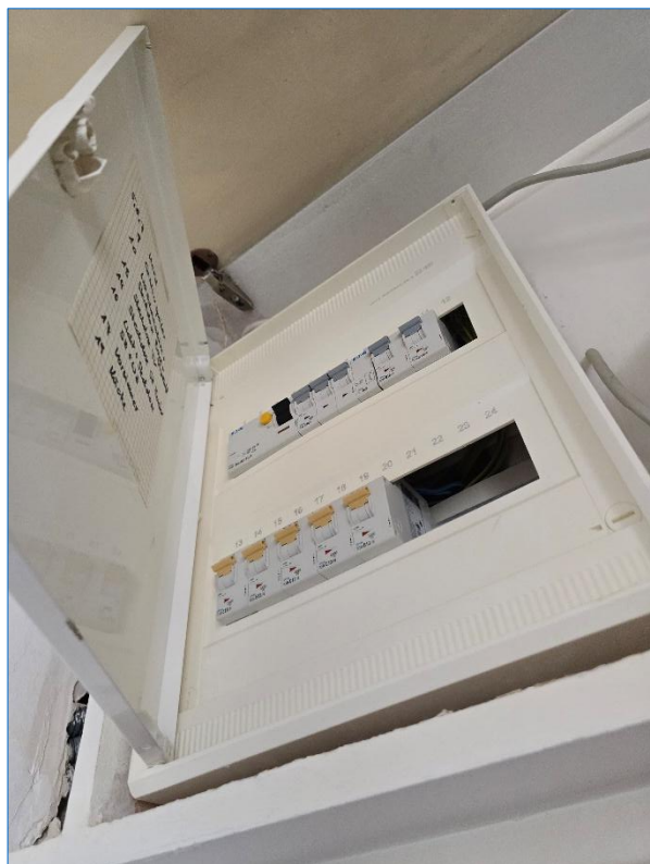
Schaltkasten oberhalb von Eingangstüre © eigene Bilder
