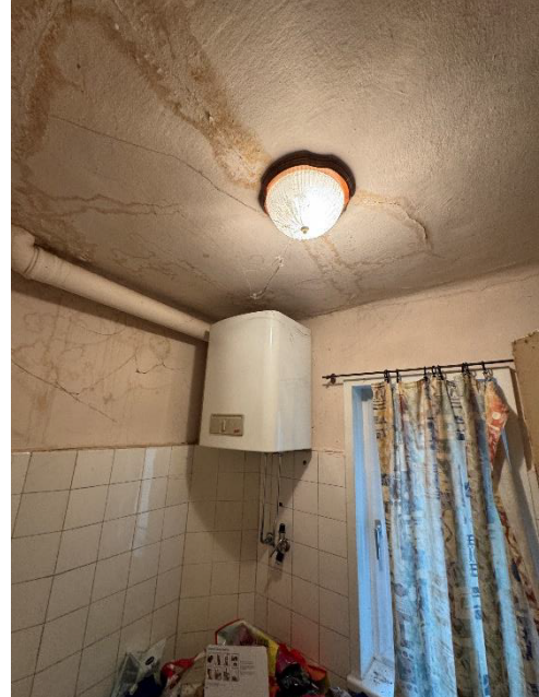
Bild 6 von 30 Blick in das Badezimmer auf die mit freiem Auge sichtbaren Rissbildungen
