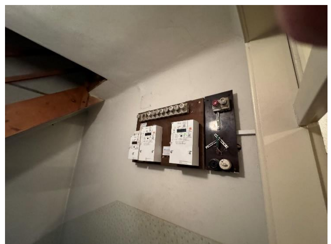
Bild 16 von 30 Blick auf einen Zählerkasten
