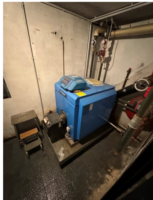
Bild 12 von 30 Blick auf den Ölheizkessel
