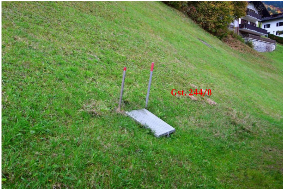
Bild 33 Quellfassung auf Gst. 244/8, bergseitig dem Tischlereigebäude
