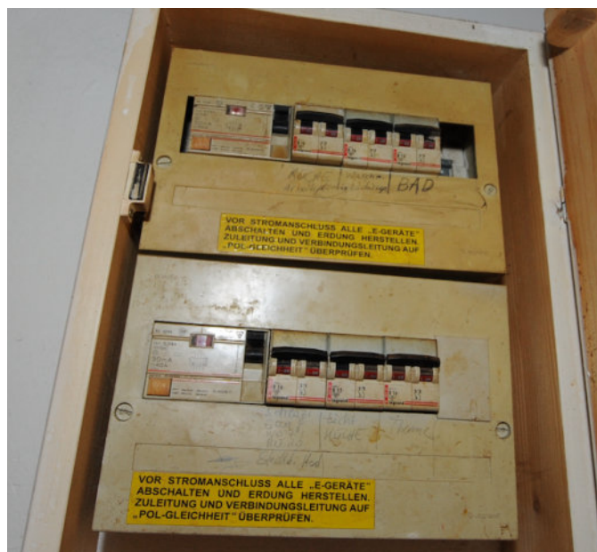
Abb. 45: Hinweis Sicherungskasten Top 7
