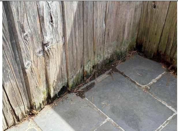
Abbildung 93: Dachterrasse; abgenutzte Verkleidung
