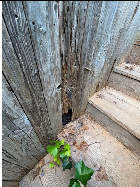
Abbildung 262: Bsp. schadhafte Holzverkleidung
