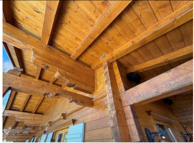
Abbildung 183: Dachuntersicht OG, Wasserflecken
