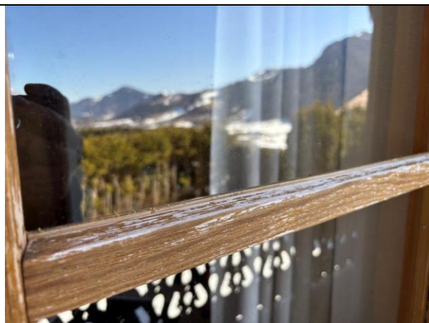
Abbildung 175: Bsp. verwitterte Bereiche
