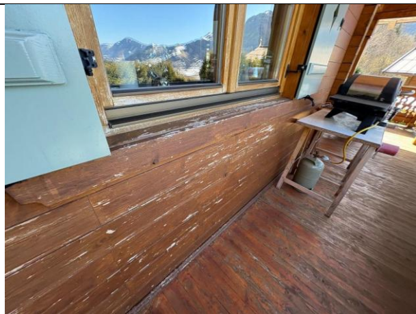
Abbildung 171: Bsp. verwitterte Bereiche
