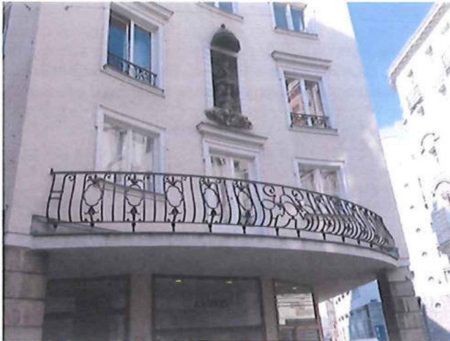
Abbildung 7: Geohrte Fenster am ggst. Haus
