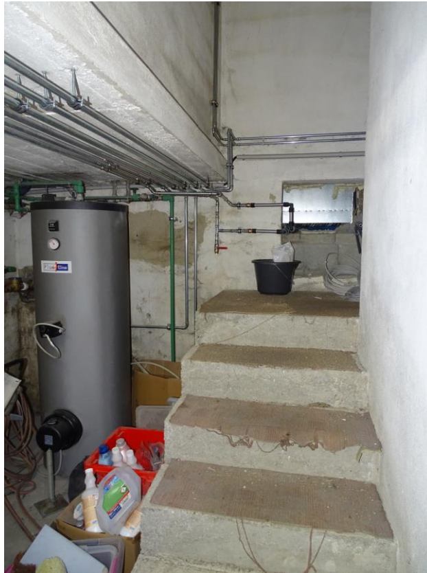
Warmwasserboiler beim KG-Stiegenabgang
