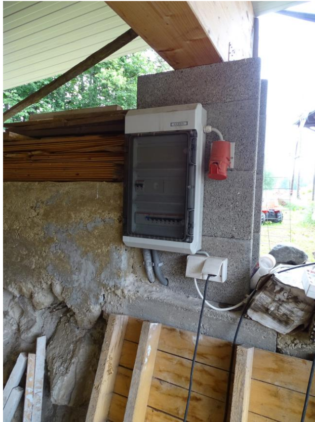
E-Subverteiler am KV-Mauerpfeiler des Unterstellplatzes
