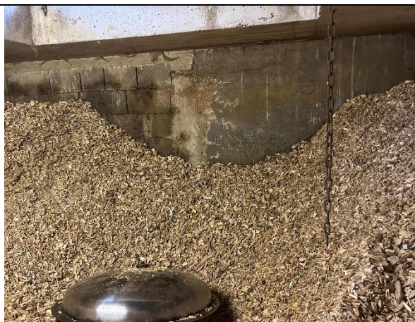
Hackschnitzelvorratsraum mit defekter Abdeckung ins Freie
