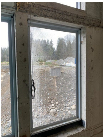
Abbildung 153, EG, Vorraum, Fensterverschmutz.
