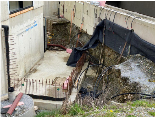
Abbildung 29, nicht fertig gestellter Pooltechnik-Raum
