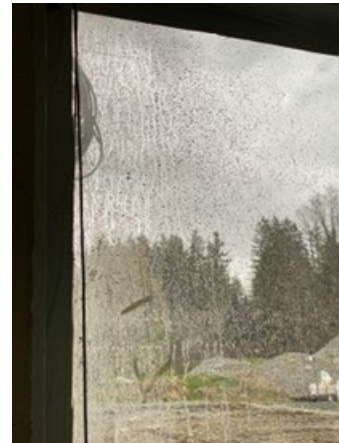
Abbildung 152, EG, Vorraum, Fensterverschmutz.
