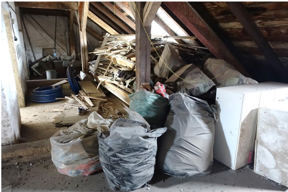
Foto 17 – Dachboden mit diversen Ablagerungen
