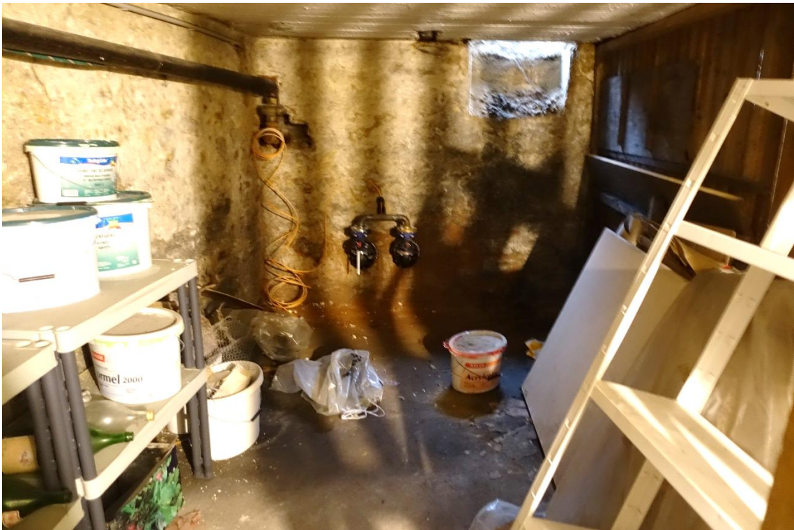
Foto 11 – Kellerabteil mit Hausanschluss für Gas und Fernwärme
