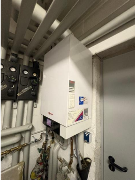
Abbildung 181: Haustechnik – Viessmann Gastherme
