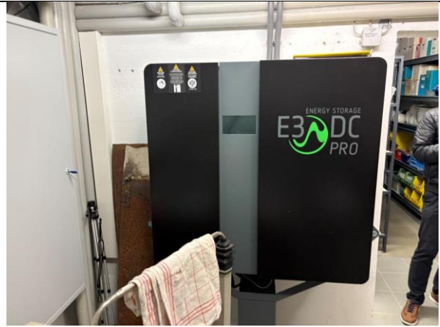
Abbildung 184: Haustechnik E3DC Pro PV
