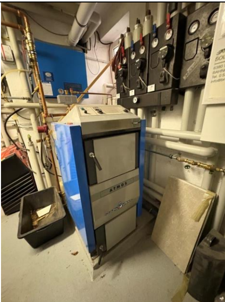
Abbildung 179: Haustechnik – Atmos Holzvergaser
