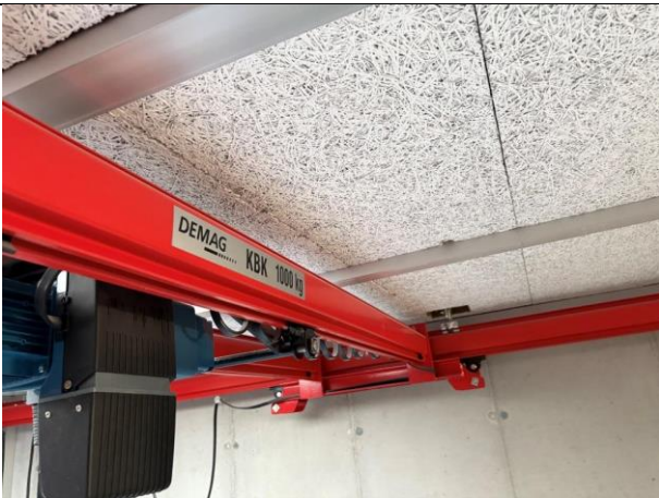
Abbildung 212: Atelier & Werkstatt – DEMAG Kransystem
