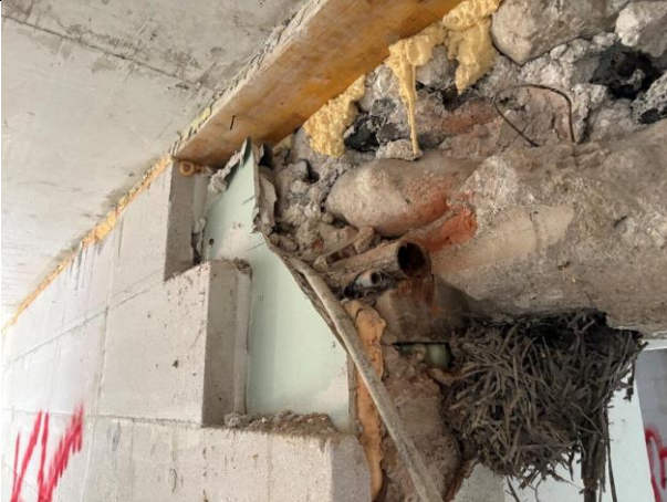
Abbildung 89: Bsp. laienhafter Wandaufbau
