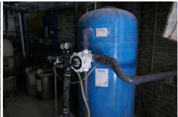
Vorhandene Installation im Technikraum ohne Funktion
