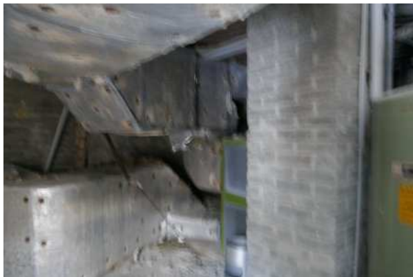
Vorhandene Lüftungsinstallationen ohne Funktion im Technikraum
