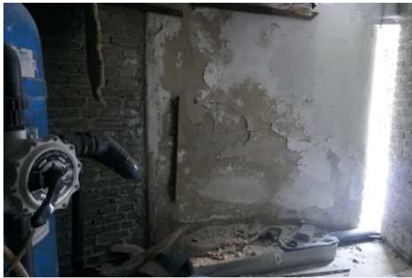
Vorhandene Lüftungsinstallationen ohne Funktion im Technikraum, Baufeuchtigkeit
