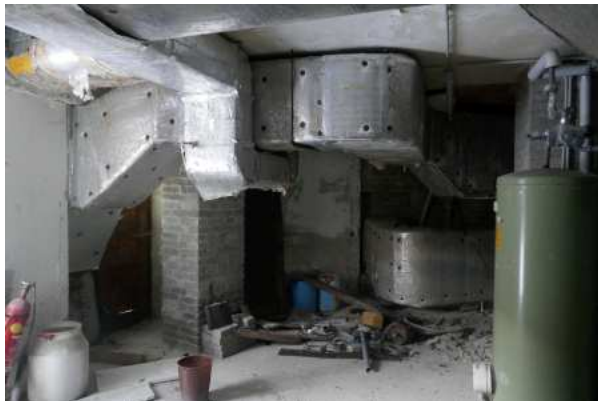
Vorhandene Lüftungsinstallationen ohne Funktion im Technikraum
