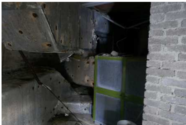
Vorhandene Lüftungsinstallationen ohne Funktion im Technikraum
