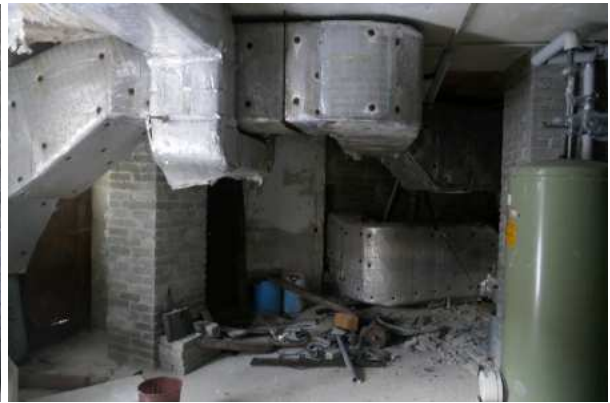
Vorhandene Installation im Technikraum ohne Funktion
