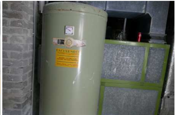
Vorhandene Installation im Technikraum ohne Funktion
