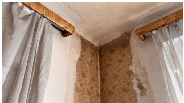
Vermutete Mauerfeucht im Ichsenbereich zu Seite Straße
