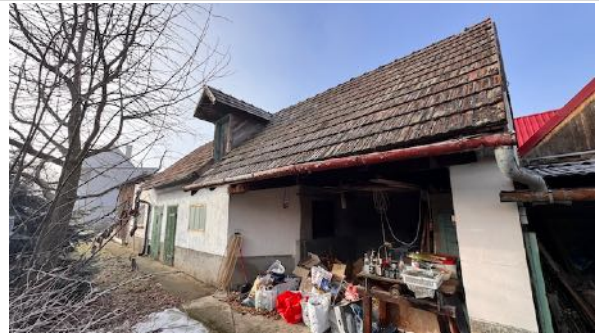
Desolate und technisch überaltete Hofnebenobjekte
