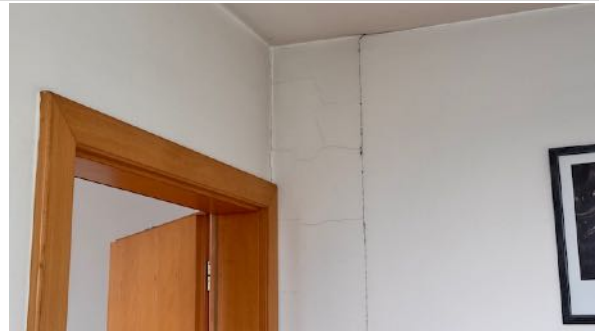
Horizontale und vertikale Rissbildungen im Wandbereich
