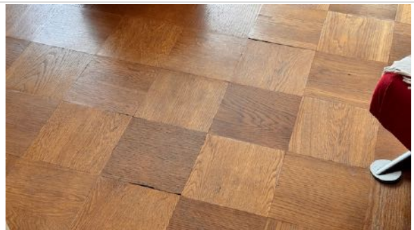
Beschädigtes und abgewohntes Parkett
