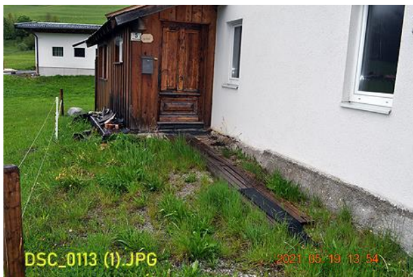
Zustand der "Befestigung" für Top P1 anlässlich des Augenscheines
