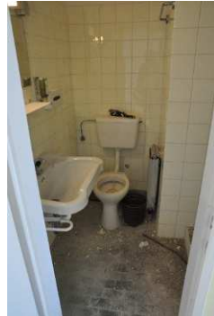
Wasserschaden in Z 111
