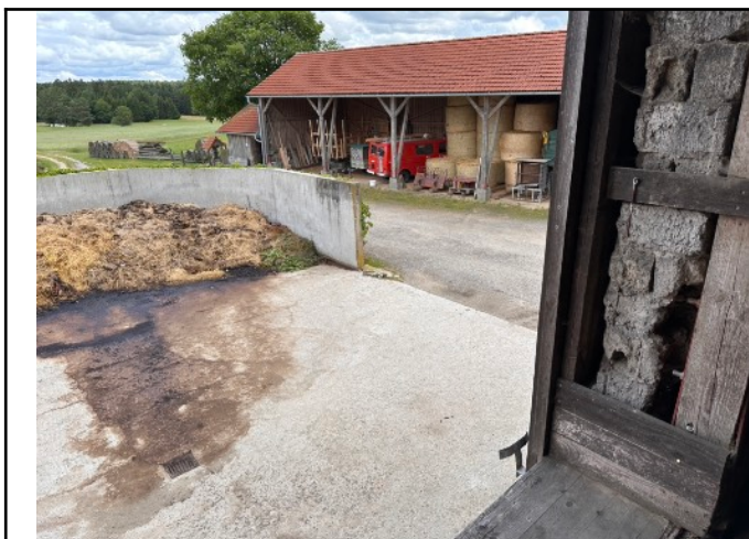
Düngesammelstelle mit darunter liegender Güllegrube
