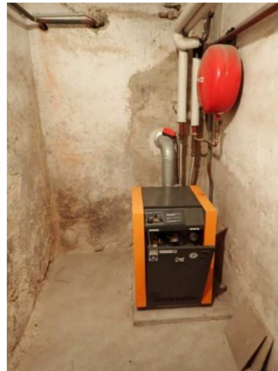
Heizraum mit Heizung für die Top 2
