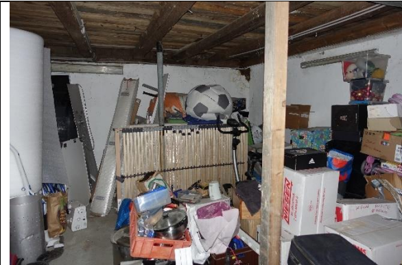
Abstellraum 2 - ehemaliger Rinderstall: Boden: Beton; Wände: verputzt und gemalt; Decke: Holzbalkendecke mit Bretterbelag;
