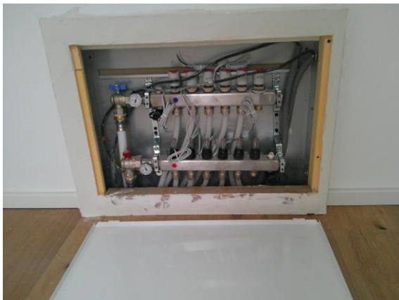
Foto 27: Top 14 | Verteiler Fußbodenheizung
