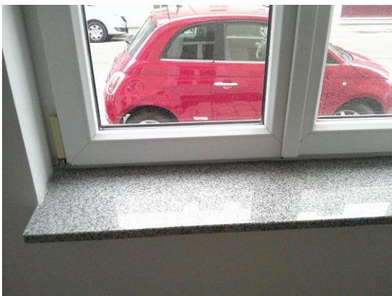
Foto 17: Top 1A | Fensterbrett
