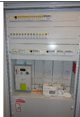
Elektroverteiler- und Zählerschrank
