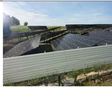
Blick vom Haus auf die PV Anlage
