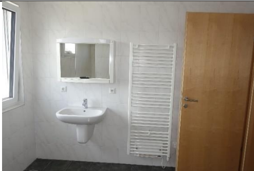
Bad: Sanitärausstattung: 1 Dusche mit zwei-flügeliger Glasdrehtür und Armatur, 1 Eckbade-wanne mit Armatur, 1 Waschbecken mit Spiegel-schrank, 1 Handtuchheizkörper;
