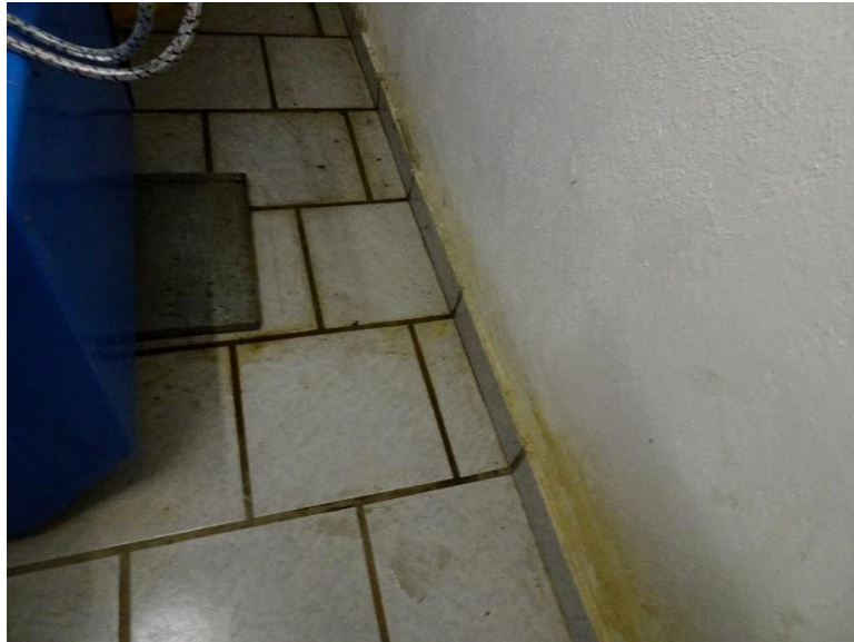
Wasserlache, Ursprung Rohrleitungssystem der Heizanlage
