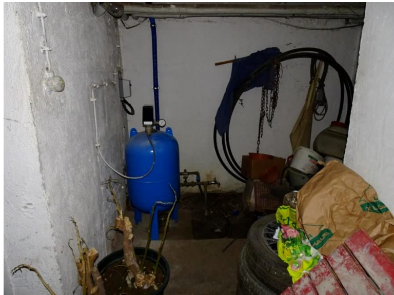
Pumpanlage für Trinkwasser
