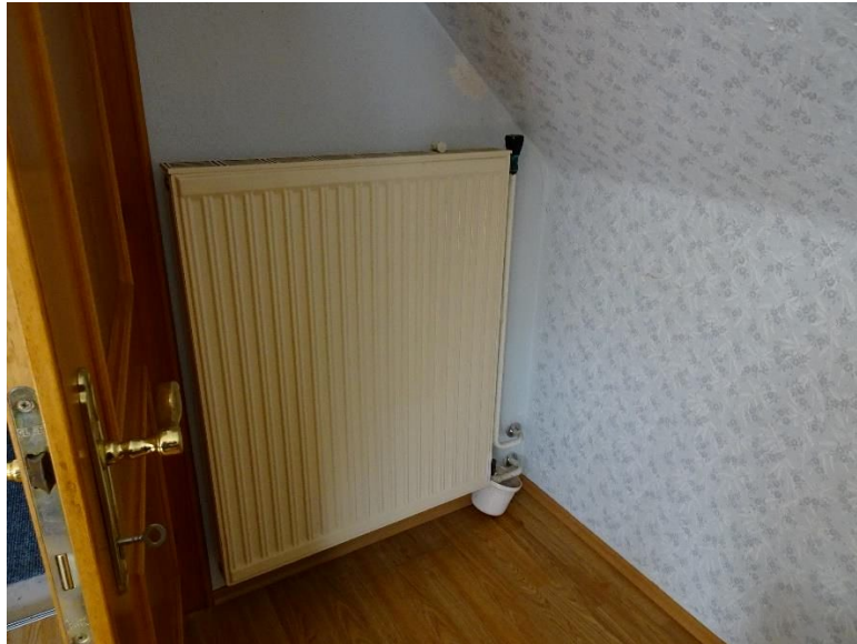
Heizkörper, teils schadhaft
