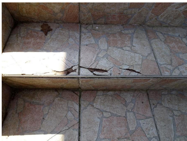
schadhafter Fliesenbelag beim Hausaufgang
