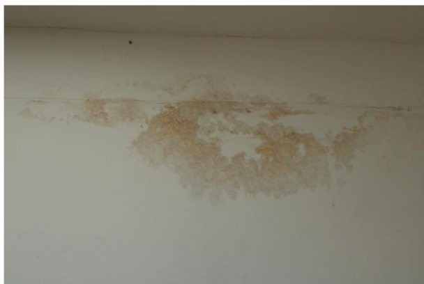
Spuren von Feuchtigkeit im OG (Sanierungsbedarf)
