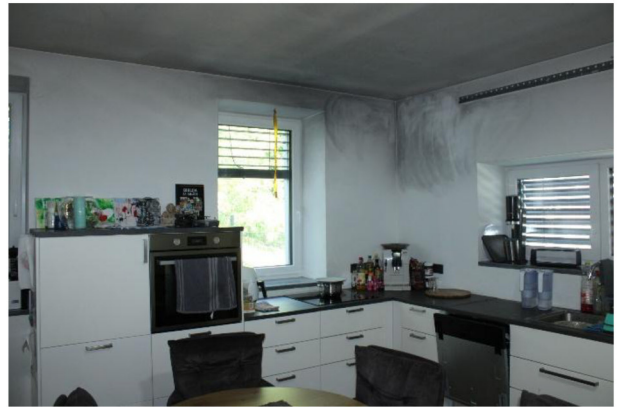
Küche (Sanierungsbedarf nach Rauchentwicklung)
