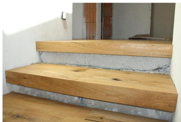
Treppe in OG (Fertigstellungsbedarf)
