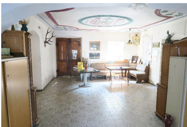
Das Wohnhaus verfügt über ein großes Vorhaus. Das Mauerwerk ist teilweise von Schimmel befallen.
