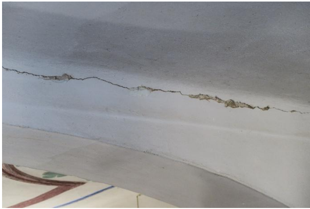
Risse im Mauerwerk
