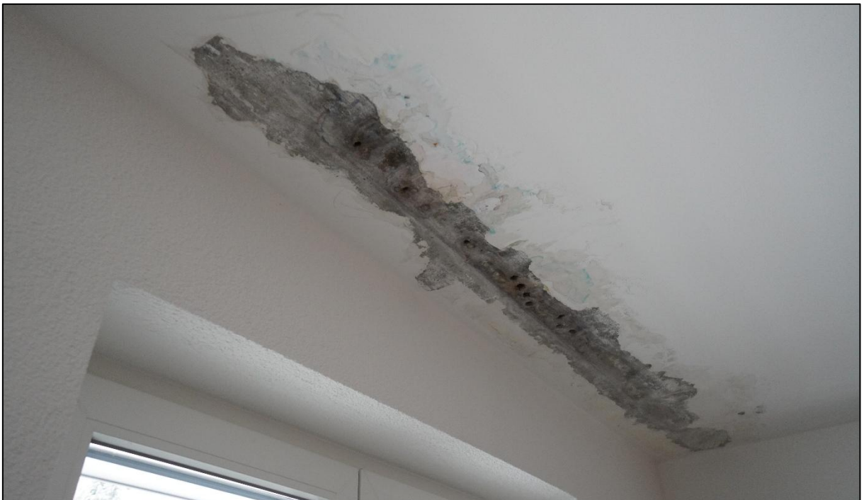
Schäden an der Decke der Erdgeschoßwohnung (TOP 1)
