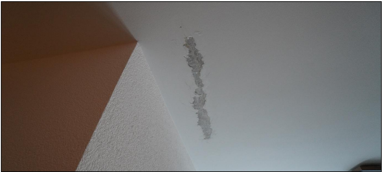
Schäden an der Decke der Erdgeschoßwohnung (TOP 1)
