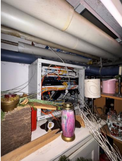
Bild 17 von 60 Blick auf den Serverkasten
