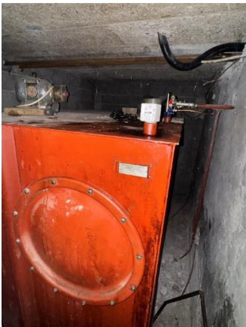
Bild 19 von 60 Blick auf den Öltank
